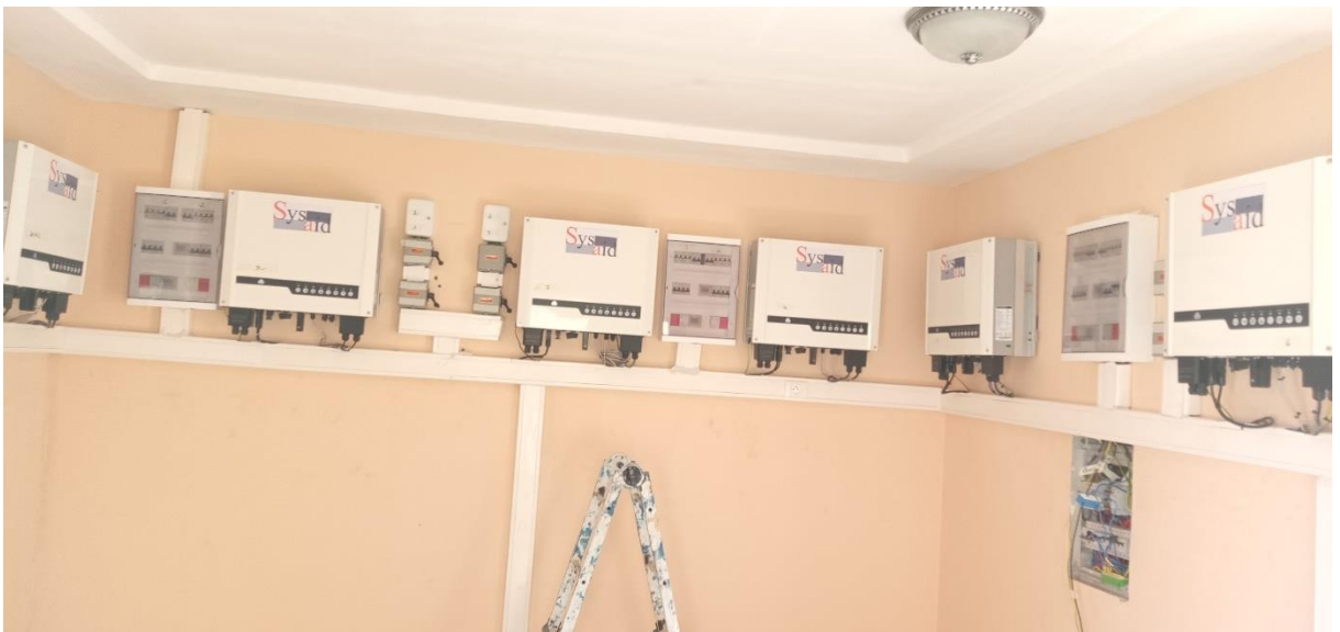
Figure 18 : Configuration des onduleurs lors de l'installation dans le dit chantier
