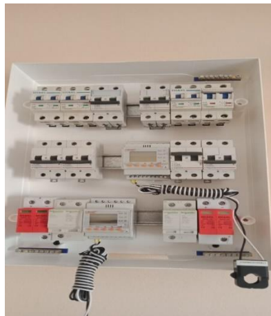
Figure 20:Présentation des éléments de protection dans le boitier..
