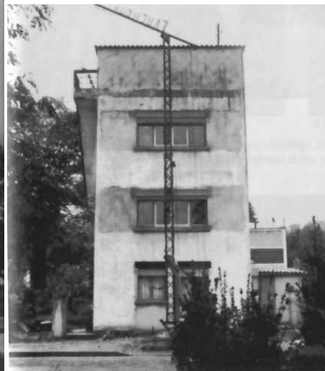
On constate ici le même type de transformation que sur le modèle précédent : réduction des baies vitrées, ajout d'un toit en pente (peu visible ici). Ces transformations se retrouvent sur presque toutes les maisons.
